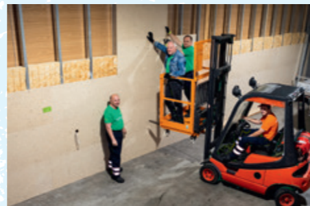
Gemeinsam aktiv vor Ort: Walfried Heinen (mit Jeansjacke) unterstützt das DRK Zülpich, hier mit Heinrich Weinand (v. l.), Gemeinschaftsleiter Thomas Heinen und Horst Weinand, über seinen Arbeitgeber Westenergie beim Bau einer neuen, wärmegeämmten Wand.
